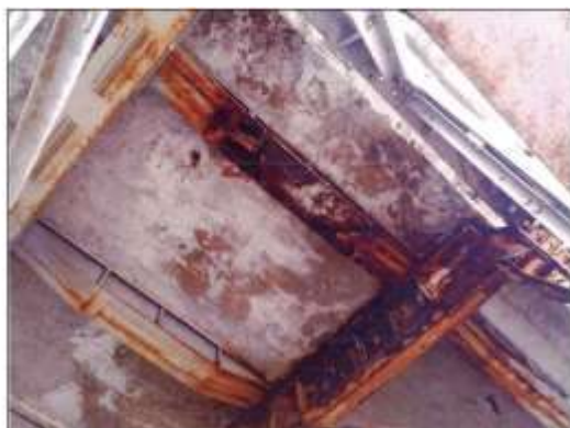
Увлажнение, размораживание бетона плиты, пластовая коррозия элементов формы в зоне опоры №2 с низовой стороны
