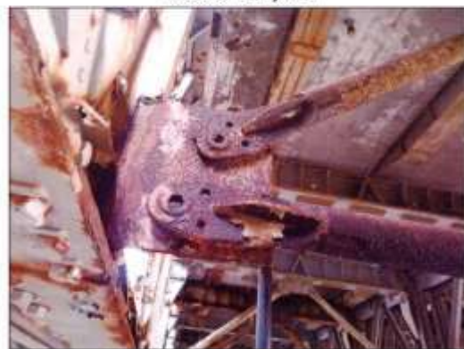
Отсутствует объединение поперечной связи с фермой Ф пролета №2
