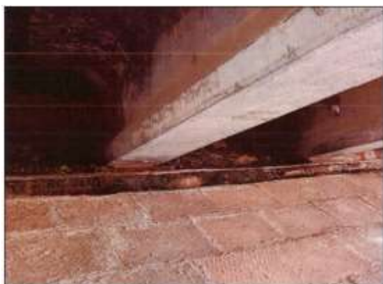
Размораживание бетона насадке опоры №1
