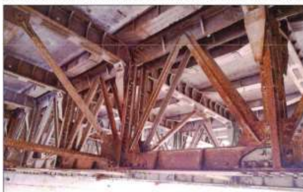
Поверхностная, местами пластовая коррозия элементов и фермы в пролете №2 с верховой стороны
