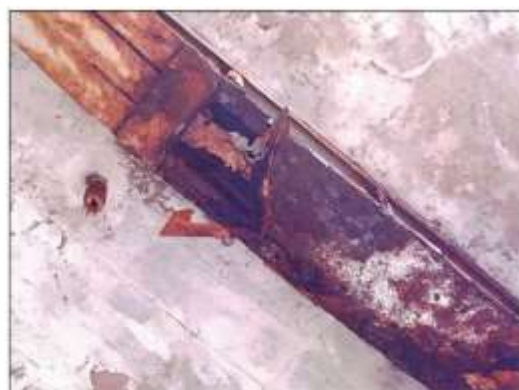
Сквозная коррозия продольной балки в зоне опоры №2 с низовой стороны
