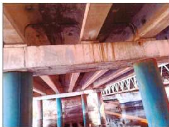
Замокание ригеля опоры №2
